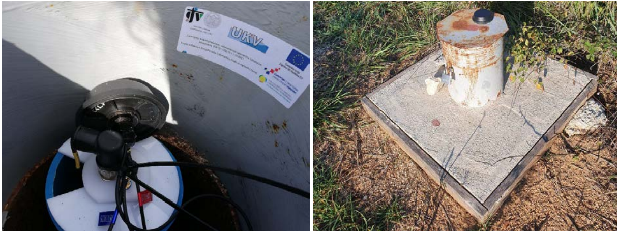
Slika 2.1-11. Ugrađeni sustav monitoringa u bušotinu BOK-1
